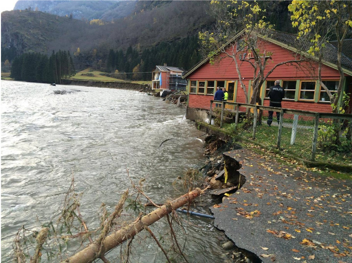
Bilde 3: Erosjon under Flåm skole. Bildet tatt 30. oktober 2014.
