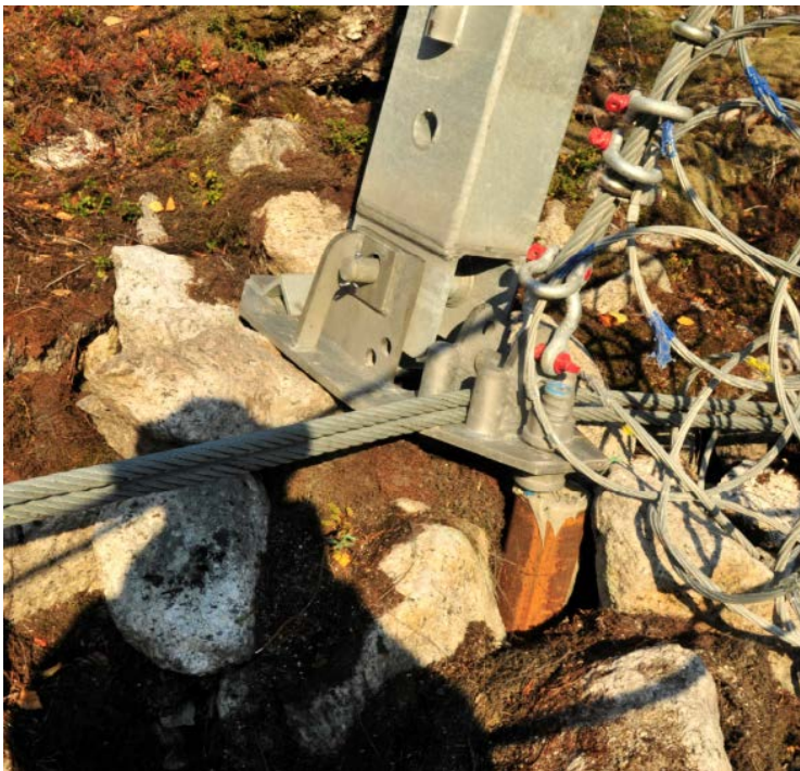
Figur 2. Til venstre vises forankring av fotplate på bergoverflate med innstøpt bolt og til høyre vises forankring av fotplate på jord/løsmasse med bolt i foringsrør til berg (Foto NGI/Henrik Langeland).
