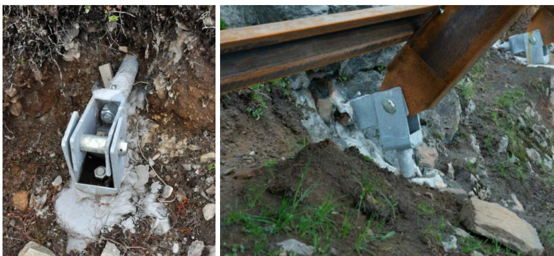
Figur 5. Til venstre er Tyrol-type fundament festet med innstøpte bolter, i foringsrør i jord/løsmasser og i borehull i underliggende berg (Foto NGI/Henrik Langeland). Til høyre vises Tyrol-type fundament festet med innstøpte bolter i berg (Foto NGI/Henrik Langeland). Dette samsvarer med forankringspunkt E i Figur 4.
