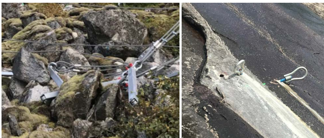
Figur 3. Til venstre vises feste av stålvaier med bremseelement til forankring innstøpt stålvaier i jord/løsmasse og til høyre vises festehode for barduner til gjerdestolpe med forankring med innstøpt bolt i berg (Foto NGI/Henrik Langeland).
