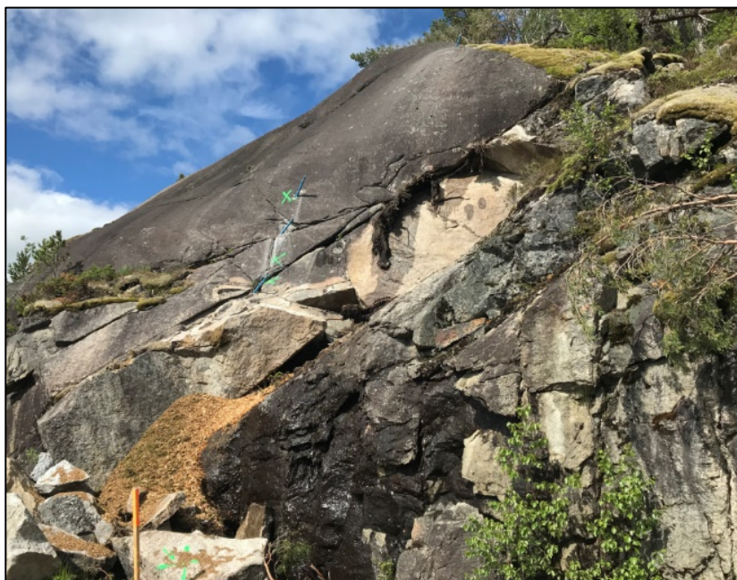
Figur 15. Eksempel på situasjon der lokalstabilitet bør vurderes for forankringen til skredsikringskonstruksjon (Foto NGI/Henrik Langeland).
