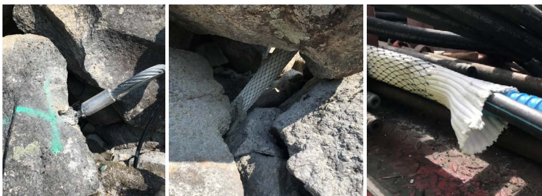
Figur 10. Eksempel på stålvaier med kause og presslås (Talurit) installert i borehull i grov ur (Foto Henrik Langeland). Stålvaier og gyseslange er kledd med strømpe og nett slik at mørtel holdes på plass rundt stålvaier i grov ur.
